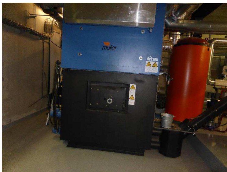
Figure 25 : Chaudière à plaquettes du centre sportif de la ville de Saint-Vith
